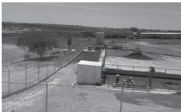
Biodigestor para tratamiento de cerdaza, instalado en San Juan de los Lagos, Jalisco.
