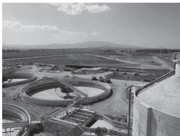
Planta de tratamiento de aguas residuales El Ahogado.
