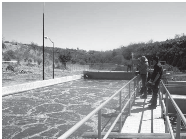
Planta de tratamiento de aguas residuales Huejuquilla El Alto, Jalisco.
