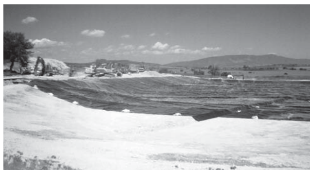
La imagen muestra la primer celda del relleno sanitario del Municipio de Jamay, Jalisco.
